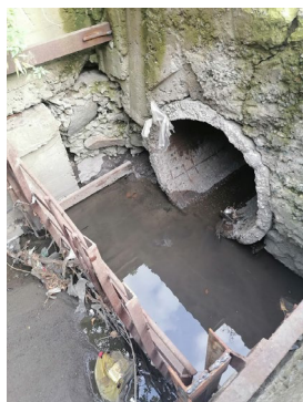
Рисунок 1. Вторичный отстойник очистных сооружений
