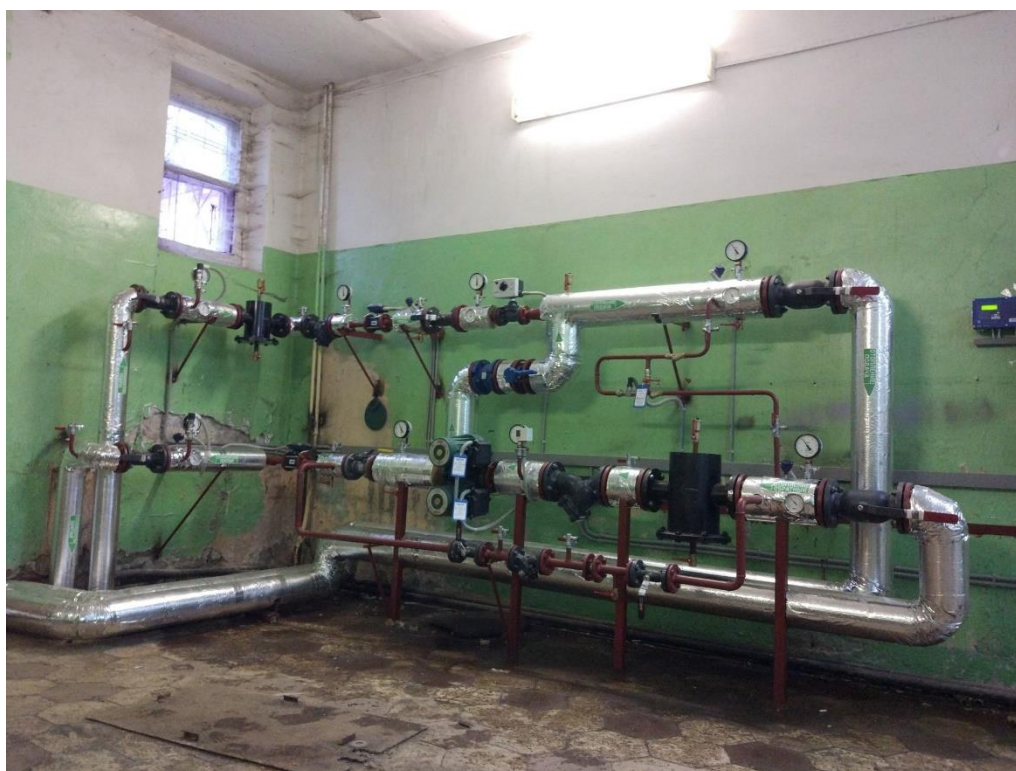
Рис. 1. Общий вид автоматизируемого теплового пункта.
