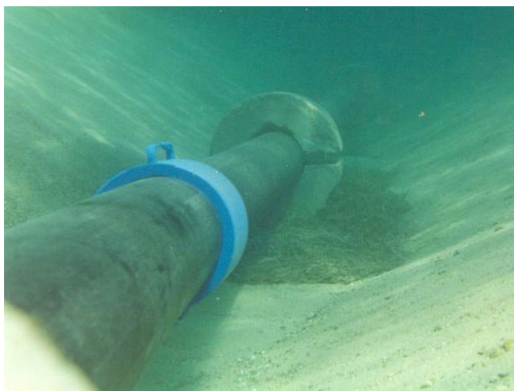
Рисунок 1.5 – Оголение подводного перехода трубопровода
