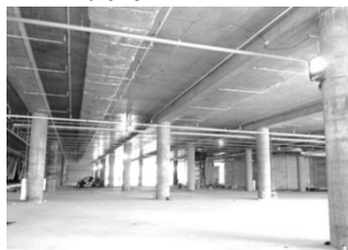
Рис. 3. ТРЦ «Авиапарк», г. Москва ТРЦ «Авиапарк» в г. Москва. Преднапряженные перекрытия с пролетом 16,8x8,4 м
